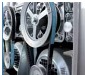
Reimene i pumpa er utsatt for slitasje.
